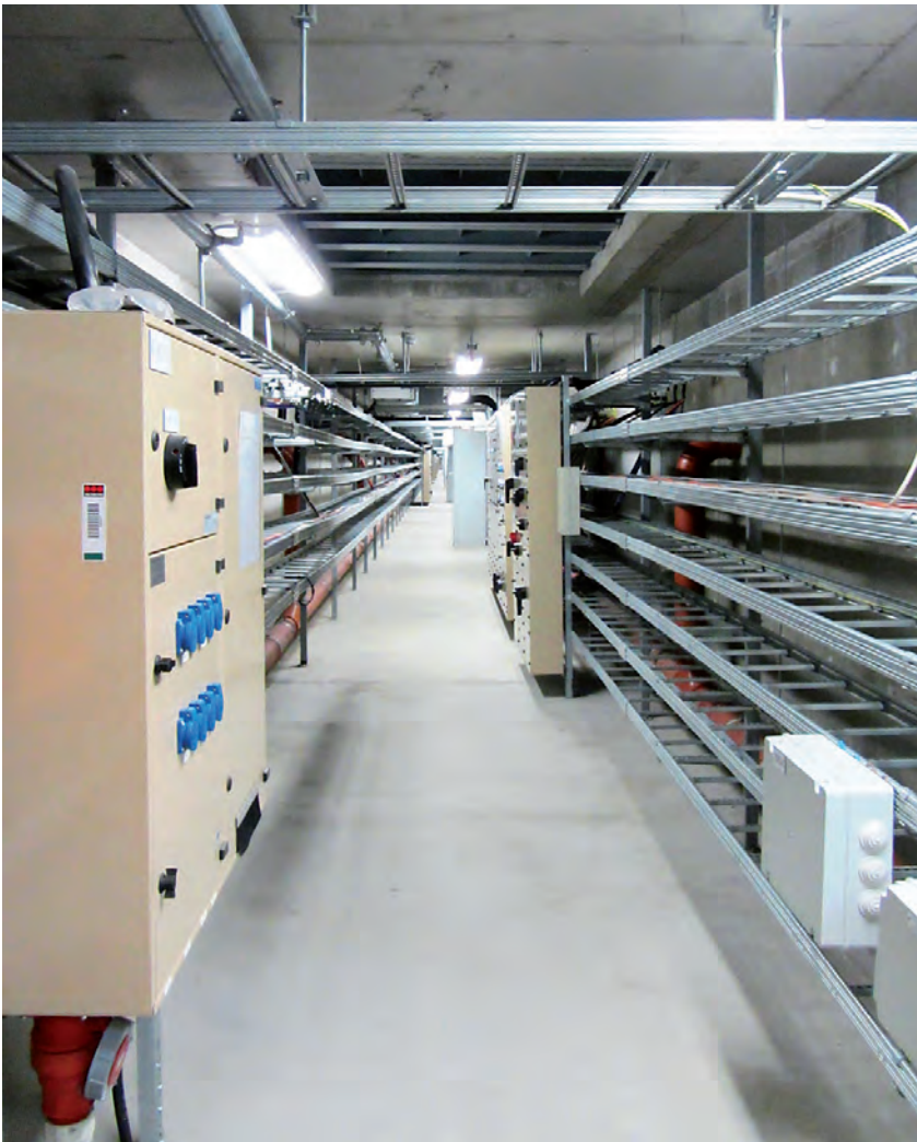
Sähkönsyöttö näyttelyosastoille tapahtuu hallin alta tavallisia ja palosuojattuja kaapeleita pitkin.
