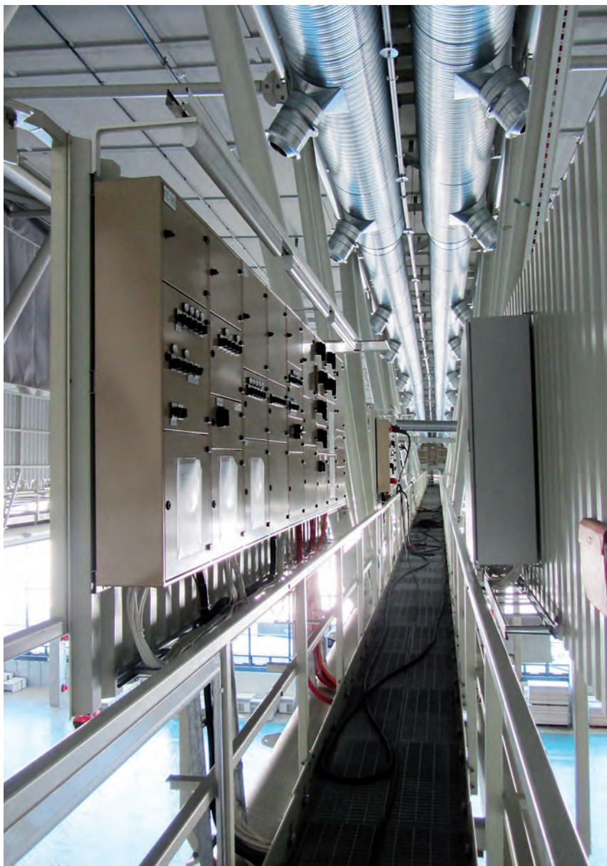
Sähkönsyöttö osastolle voi tulla myös katon suunnasta.
